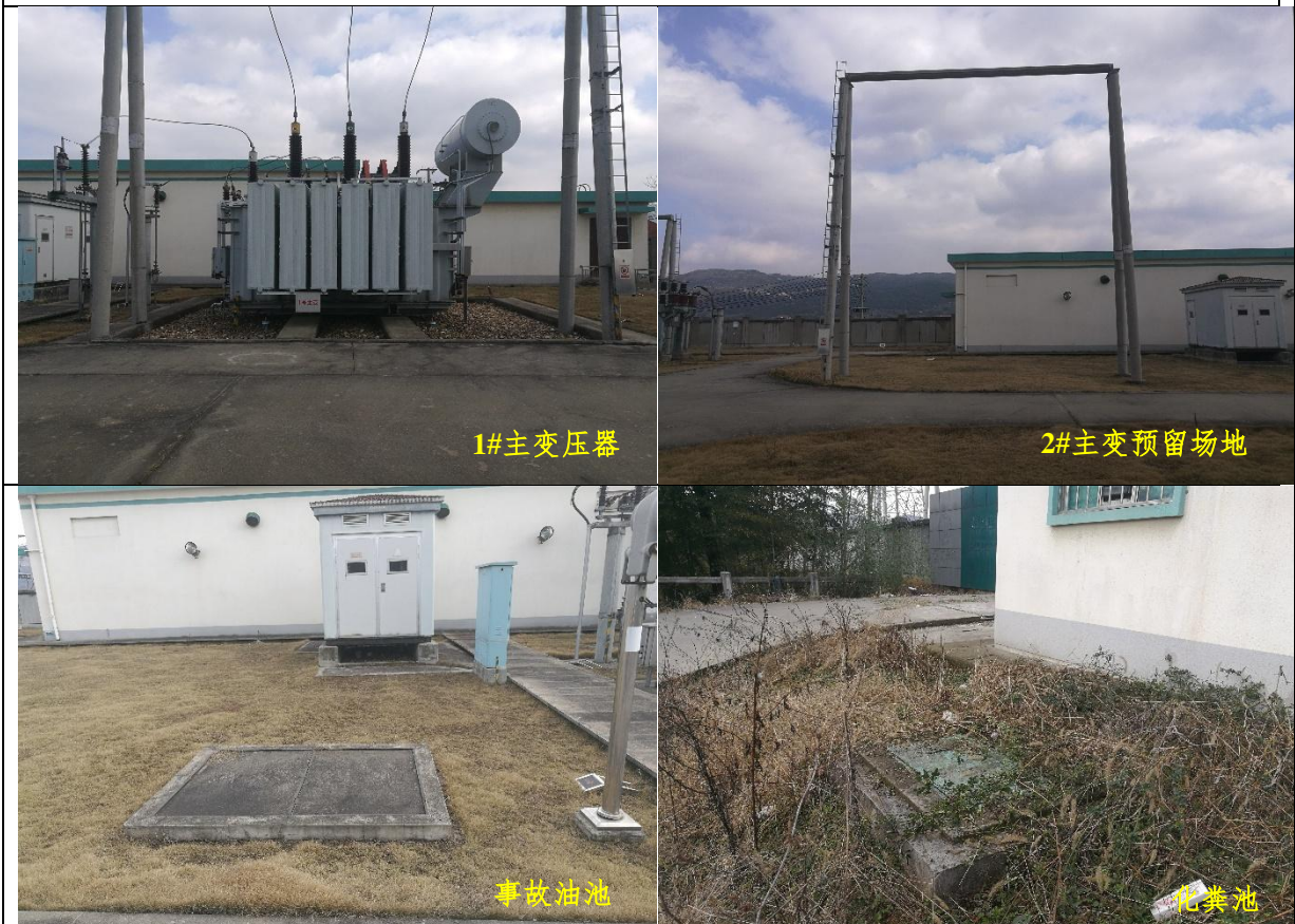
温塘 110kV 变电站站内
