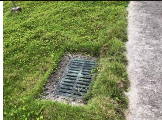
站内雨水下井
