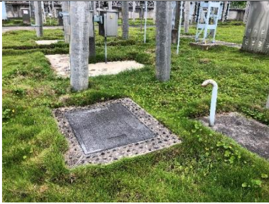
站内事故油池
