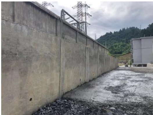
关峡 110kV 变电站西南侧
