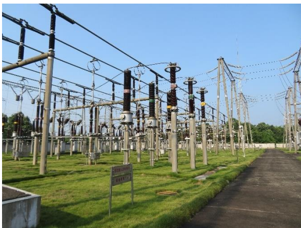
220kV配电区域
