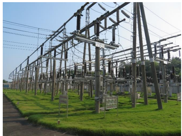
110kV配电区域
