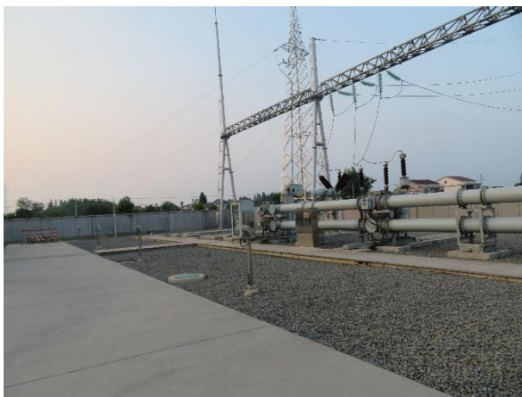
110kV配电区域
