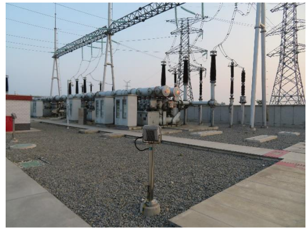
220kV配电区域
